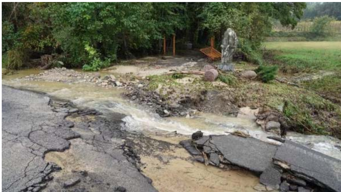
San Cristoforo, la strada per Gavi danneggiata da frane e smottamenti (fonte Stampa web)
